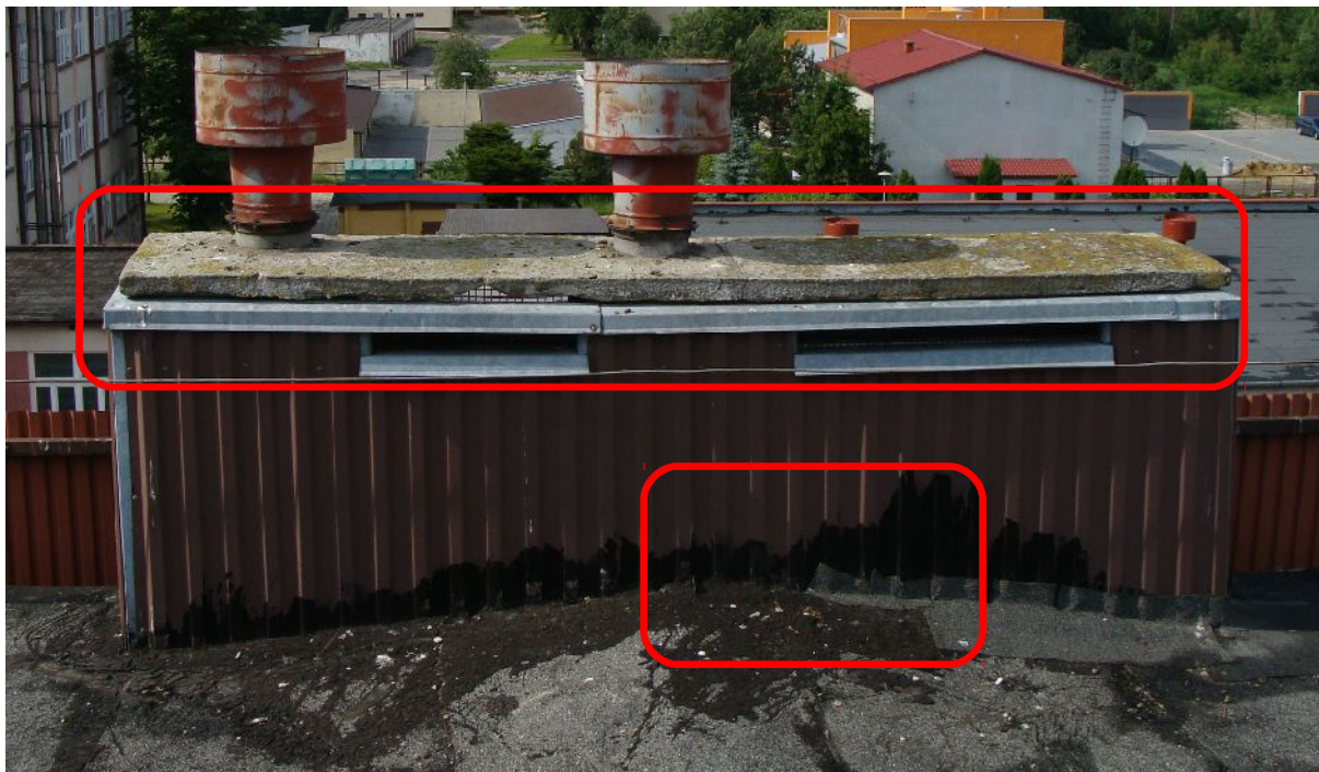
Fot. 5. Widok uszkodzeń i korozji czap betonowych i niewłaściwego wywnięcia izolacji na obudowę kominów.
