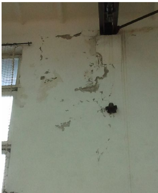
Fot. 8. Widoczne uszkodzenia tynków i malatury
