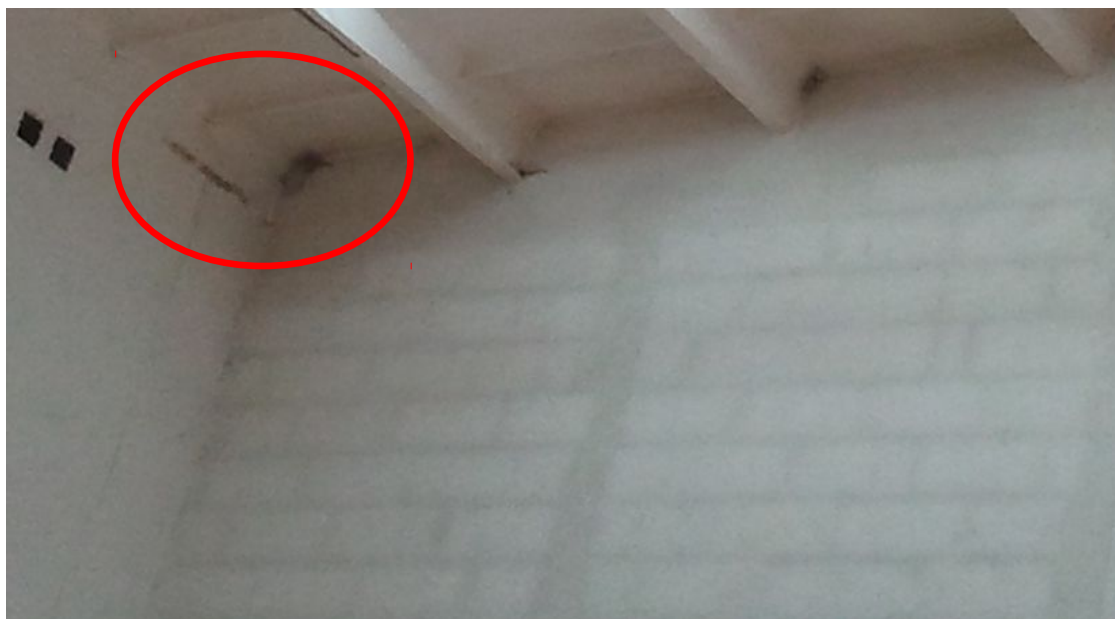
Fot. 9. Widoczne zawilgocenie naroża i rysunek przemarzniętych spoin i trzpieni.
