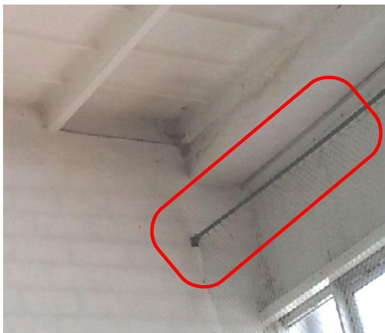
Fot. 10. Widoczne zawilgocenie naroża i rysunek przemarzniętych spoin i trzpieni.
