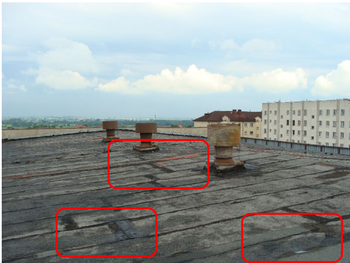
Fot. 3. Widok na dach z oznaczeniem części z wymienionych uszkodzeń .
